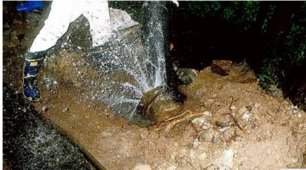
【写真】熊本地震による水道管の被害状況
