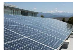
本庁舎の太陽光パネル
