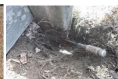
支柱地際の腐食
