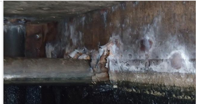
【写真】 劣化が進行した処理槽内
