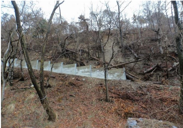
治山事業実施前
