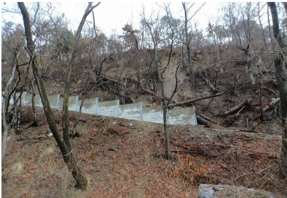
治山事業実施前
