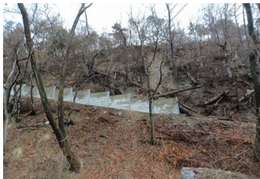
治山事業実施前
