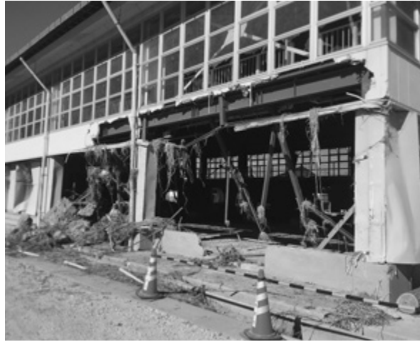
台風19号で決壊した千曲川堤防付近の体育館
