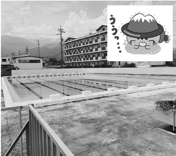
老朽化しコンクリートがひび割れた赤穂東小学校のプール 市による「子育て全力応援」宣言に期待するが……!?
