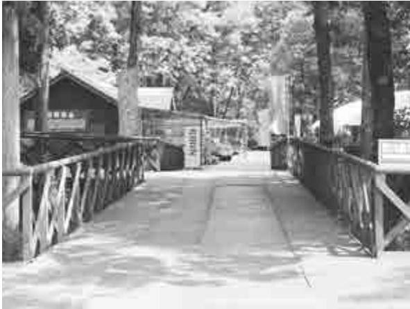
修繕が心待ちされるウッドデッキ (直売所南より)
