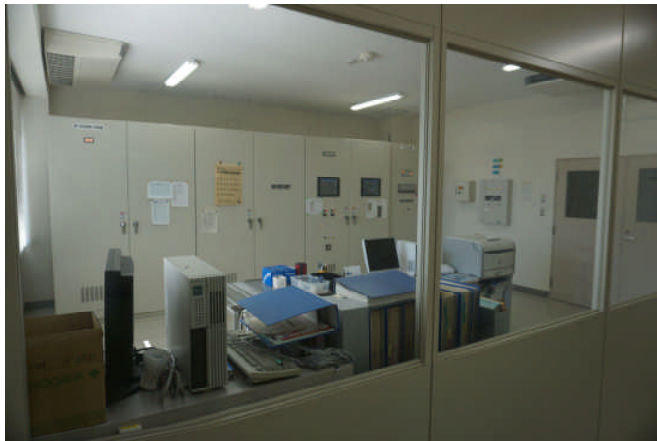
切石浄水場の中央監視室
