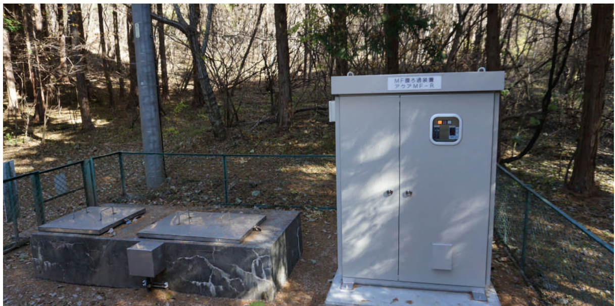
大曾倉地区の膜ろ過設備
