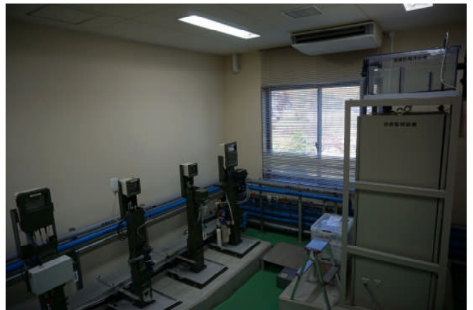
切石浄水場の水質監視装置
