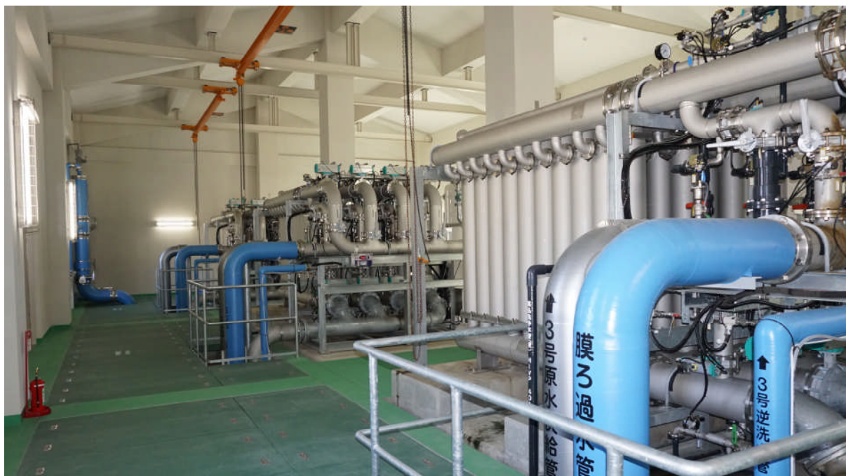
切石浄水場内部の膜ろ過装置
