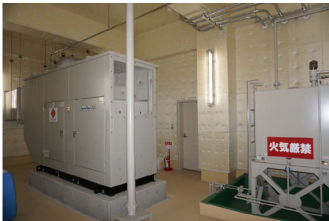
切石浄水場の自家発電装置
