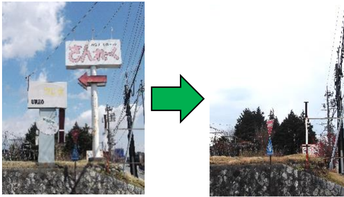
適合化事業 R153 案内看板H7m → 撤去 (改善要広告物)
