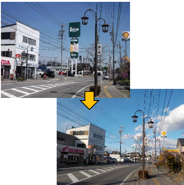
将来不適合となる既存広告物の撤去 高さ20.0mの自己敷地内看板の撤去（平成30年度）
