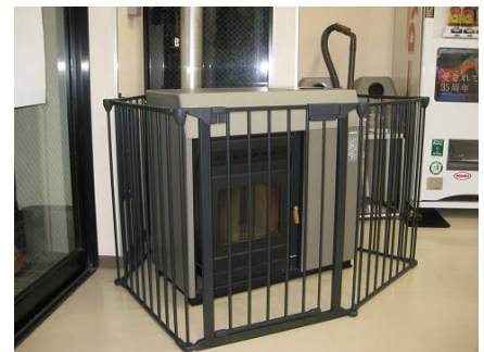
ペレットストーブの設置例
