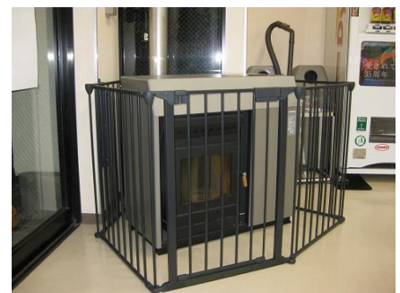
ペレットストーブの設置例
