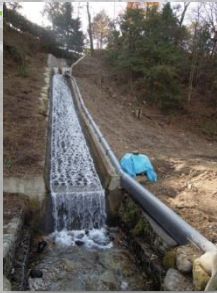
市内小水力発電第1号
