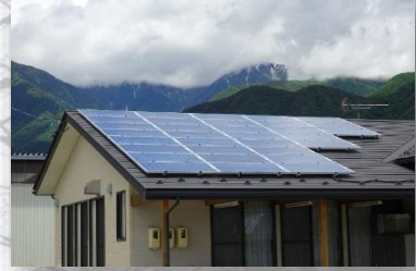
住宅用太陽光発電パネル
