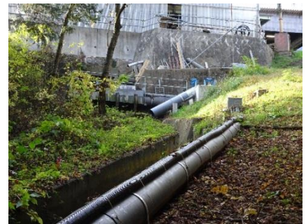
駒ヶ根市第 2 号の小水力発電所
