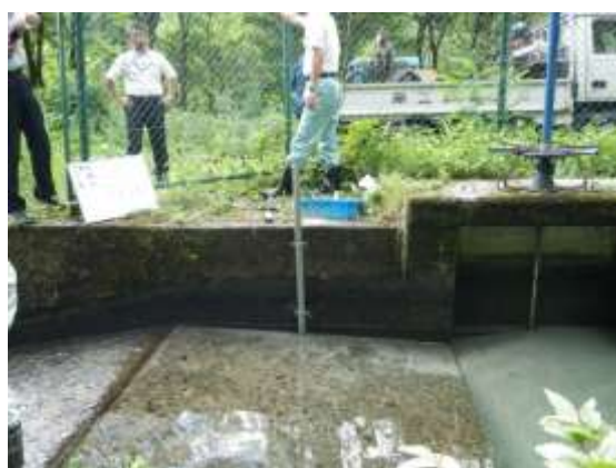
写2.2 水位計設置状況
