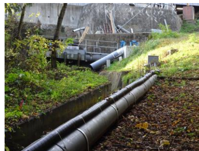
駒ヶ根市第2号の小水力発電所
