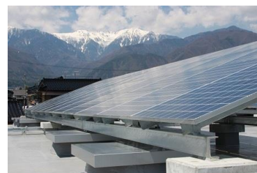
太陽光パネル(市庁舎)
