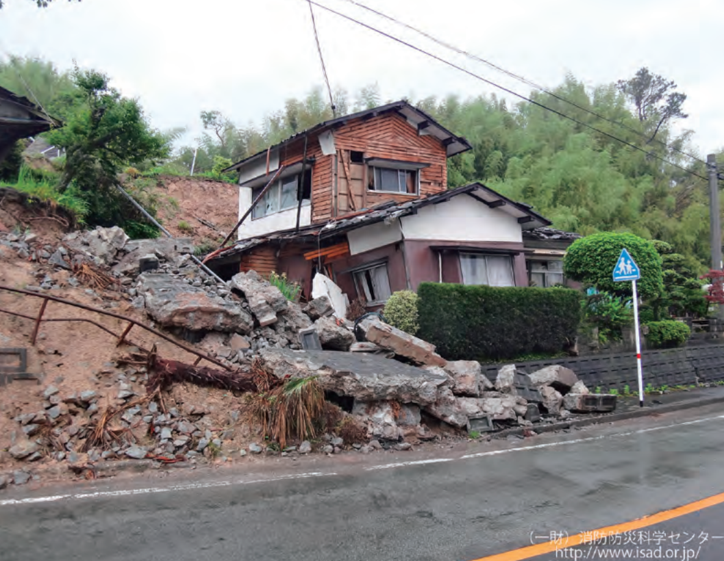
震度 7 の揺れで被害を受けた家屋 (2016年 熊本地震) 出典: (一財) 消防防災科学センター「災害写真データベース」
