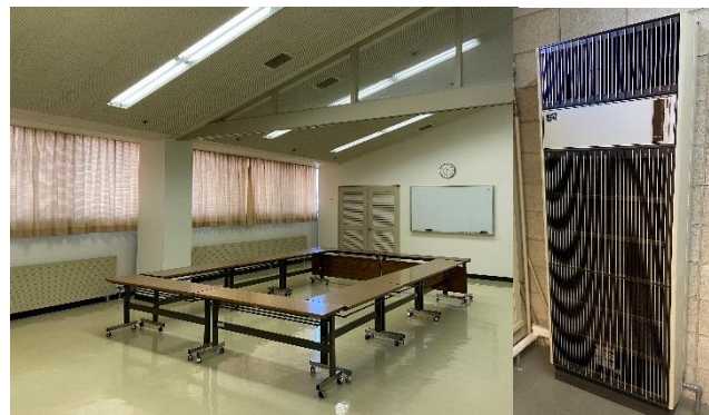
【講習室・集会室内と現在の空調設備】
