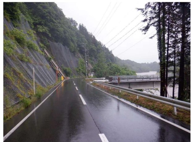
支障木伐採による視距確保 （県道伊那生田飯田線、小鍛冶大橋）
